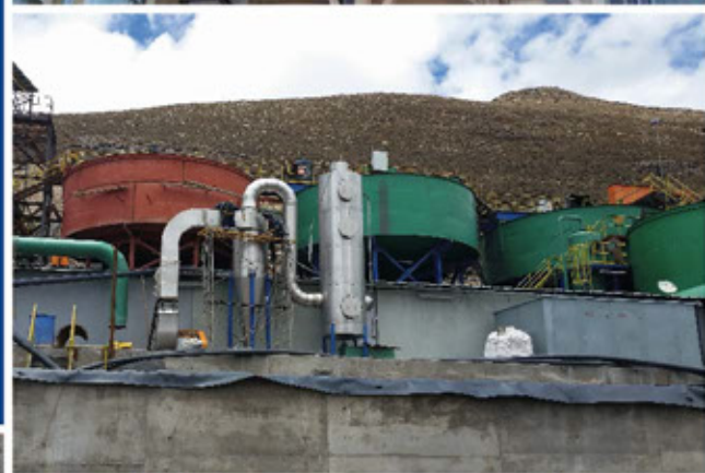
Silo de Cal 300TN
